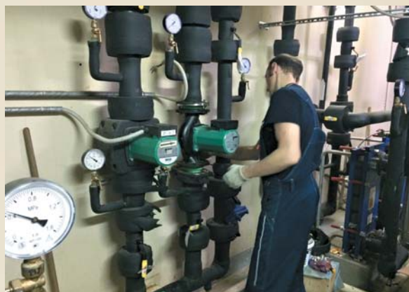
Техническое обслуживание системы отопления, ХВС, ГВС
